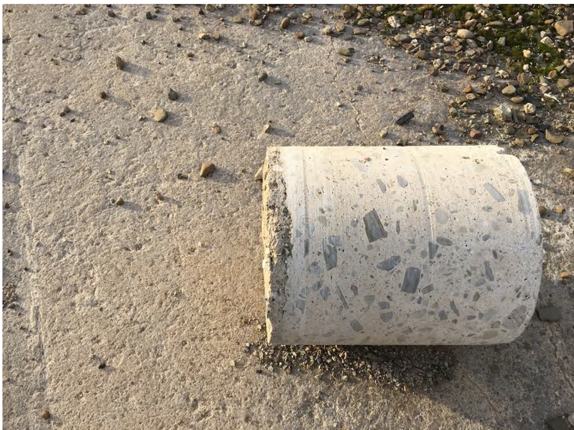
Bild 30: Bohrkern der vorh. Oberflächenversiegelung mit Anhaftungen von Müllbeton
