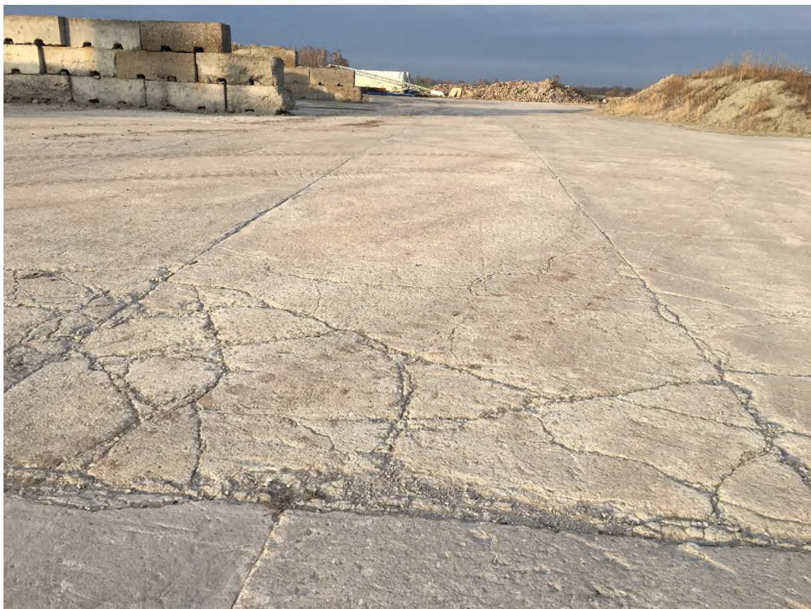
Bild 6: Risse im Beton der vorh. Oberflächenversiegelung, Blickrichtung West
