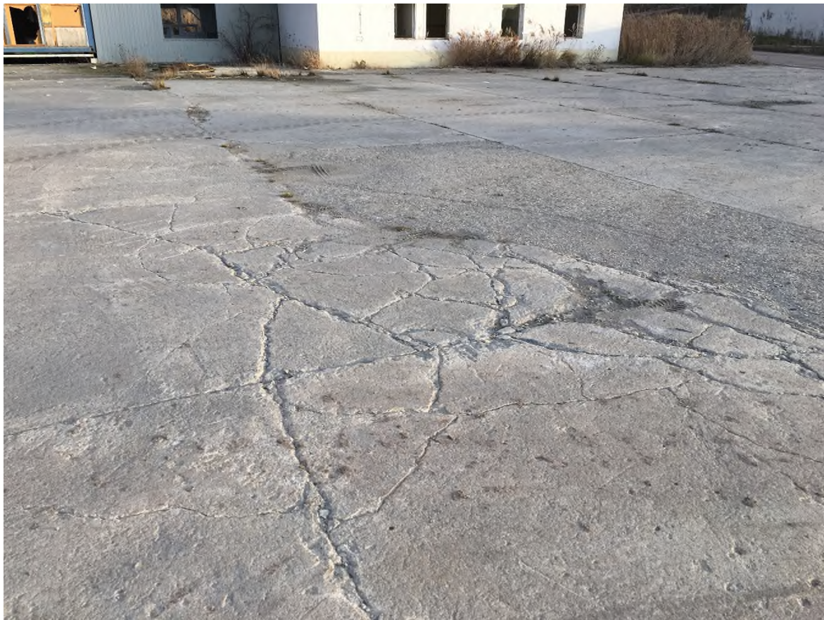
Bild 7: Risse im Beton der vorh. Oberflächenversiegelung, Blickrichtung Nord
