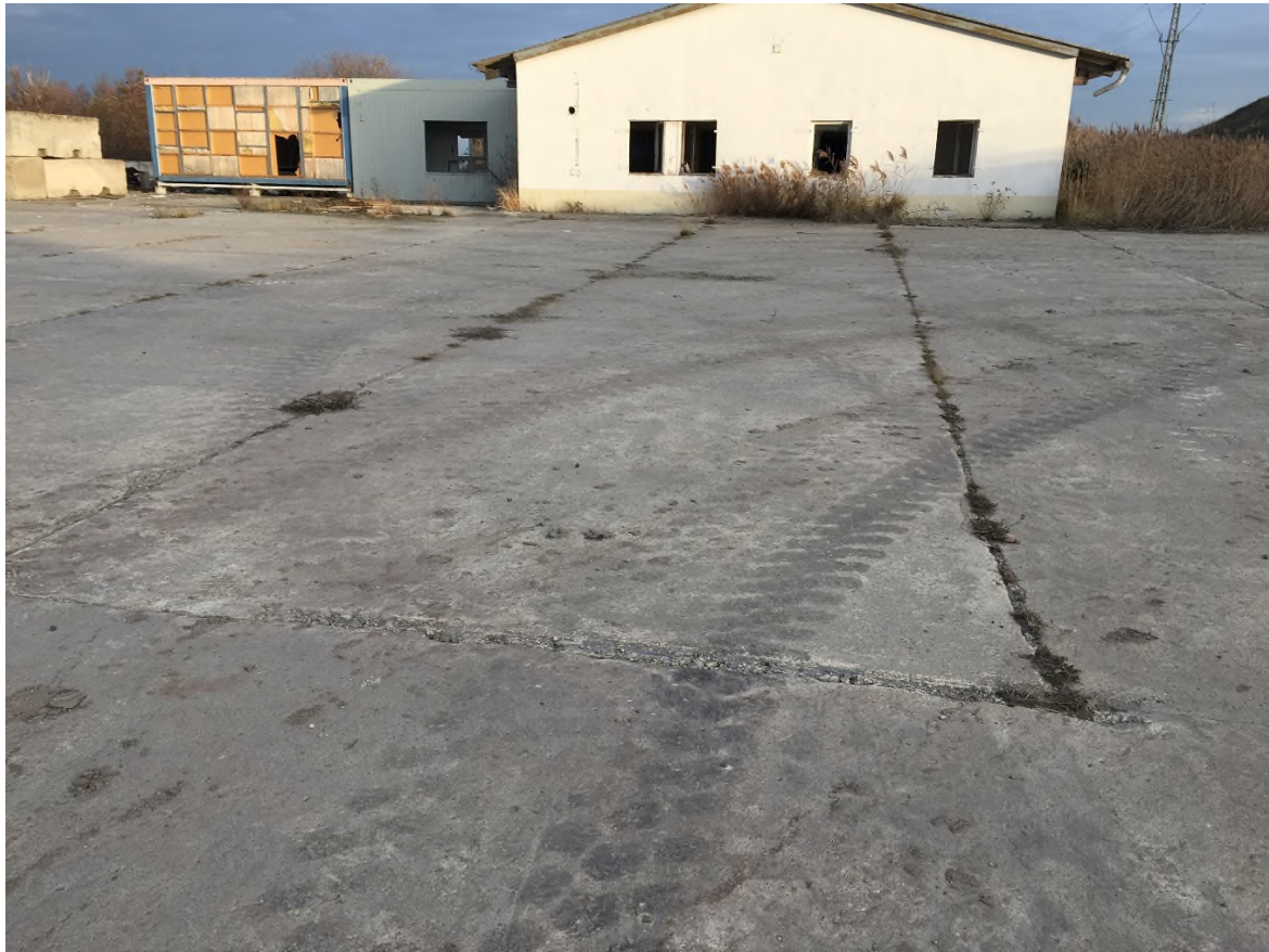
Bild 5: Fugen im Beton der vorh. Oberflächenversiegelung, Blickrichtung Nord
