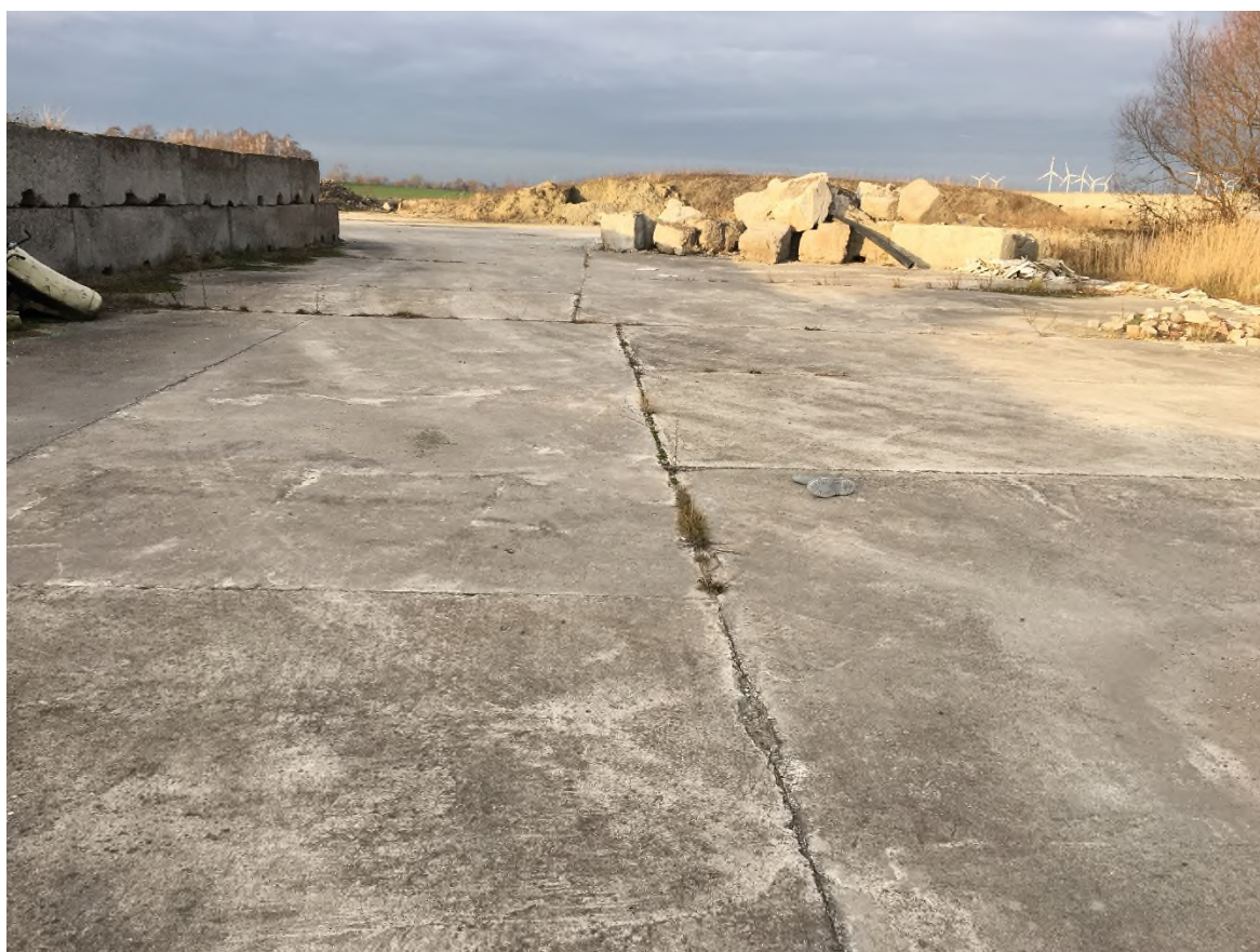
Bild 10: Fugen im Beton der vorh. Oberflächenversiegelung, Blickrichtung West
