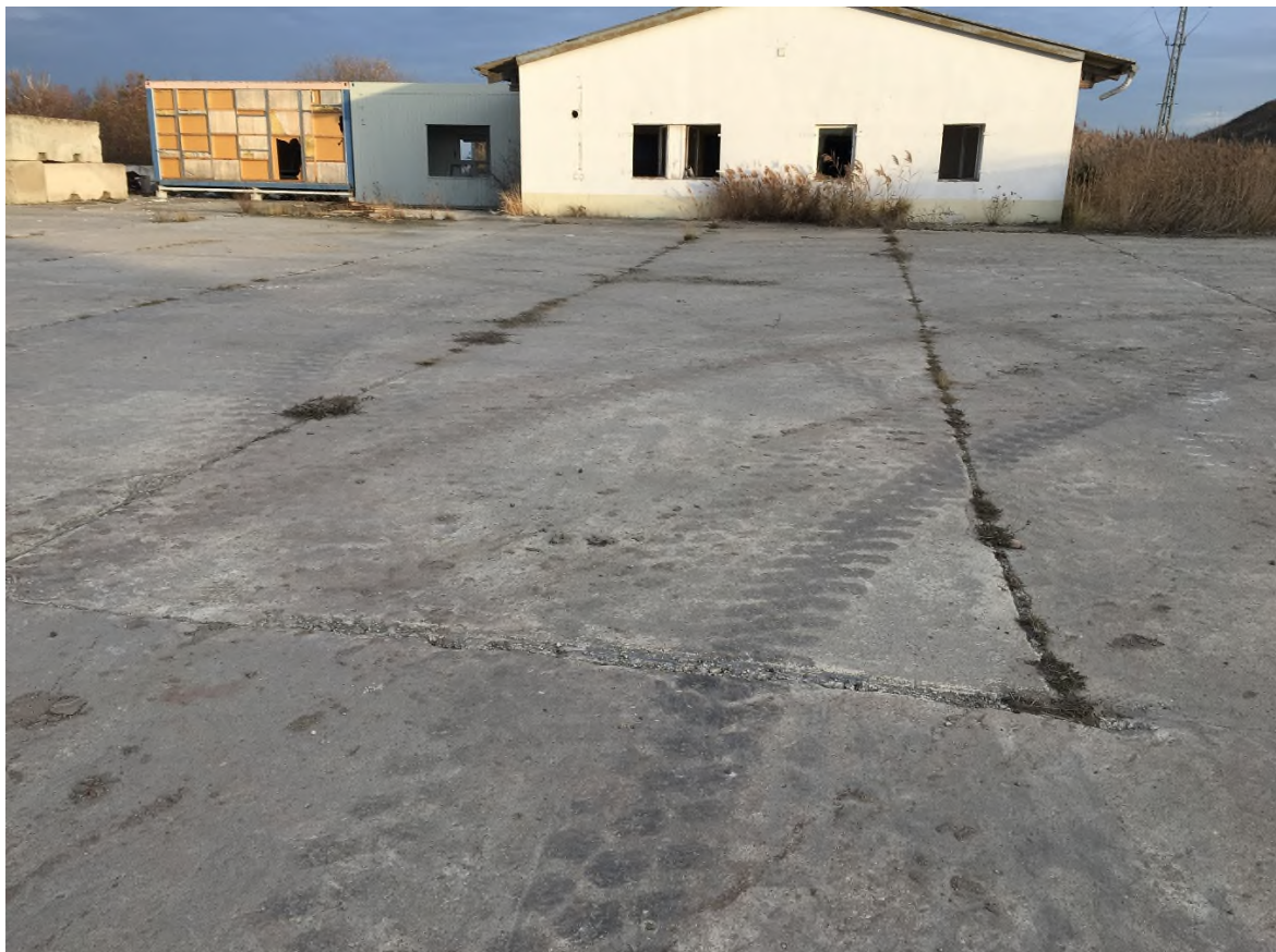
Bild 2: Fugen im Beton der vorh. Oberflächenversiegelung, Blickrichtung Nord
