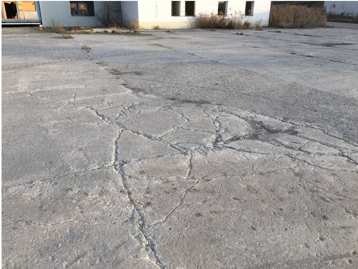
Bild 3: Risse im Beton der vorh. Oberflächenversiegelung, Blickrichtung Nord
