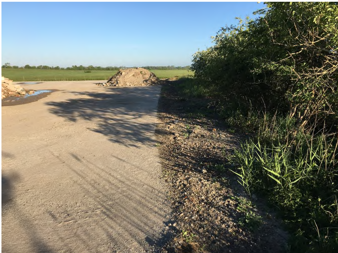
Bild 10: Nördliche Sanierungsgrenze, Blickrichtung West (Hinweis: Haufwerk wurde entsorgt)
