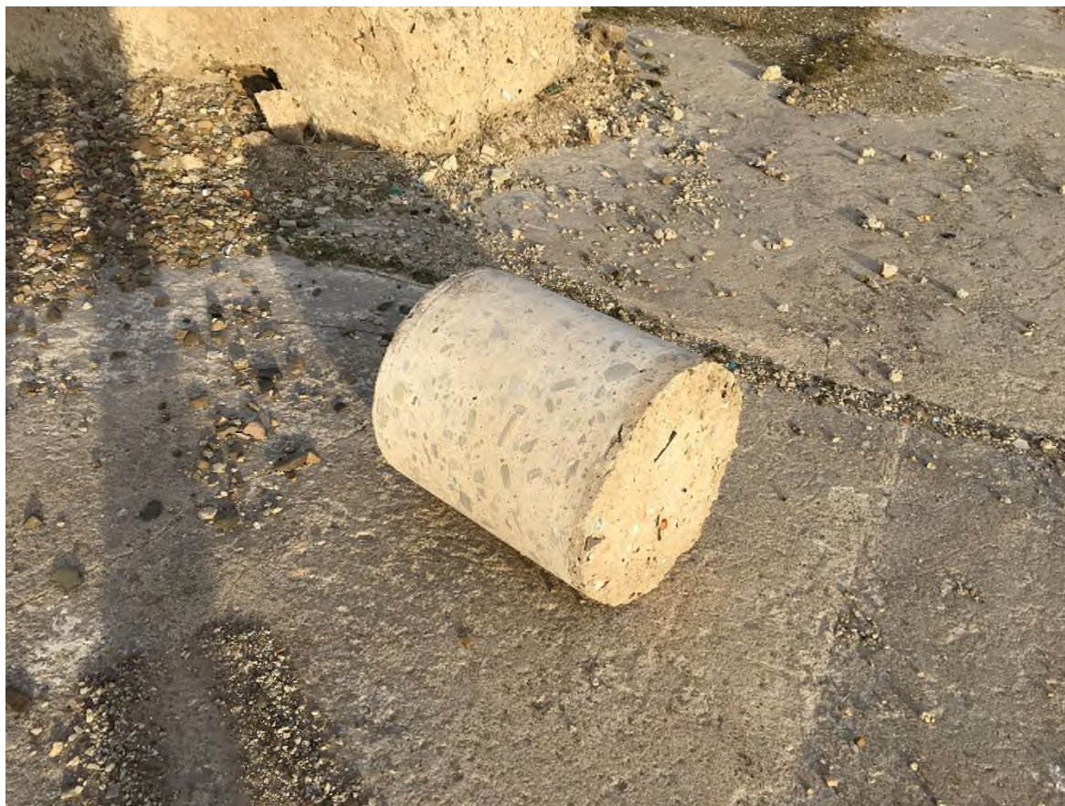
Bild 17: Bohrkern der vorh. Oberflächenversiegelung mit Anhaftungen von Müllbeton
