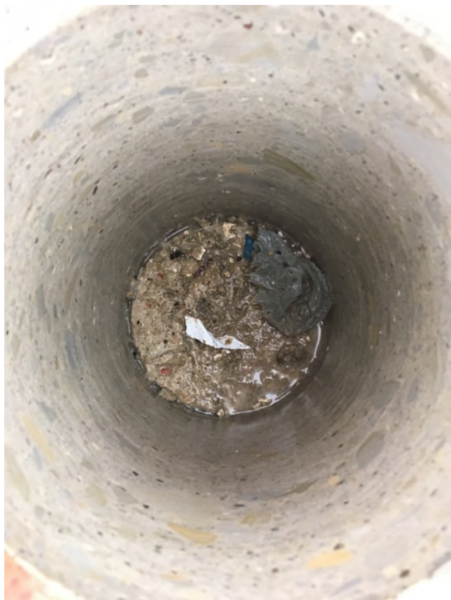
Bild 18: Innere eines Bohrkernlochs, Müllbeton am Grund
